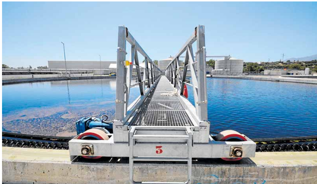
EDAR de Guadalmansa.sur
